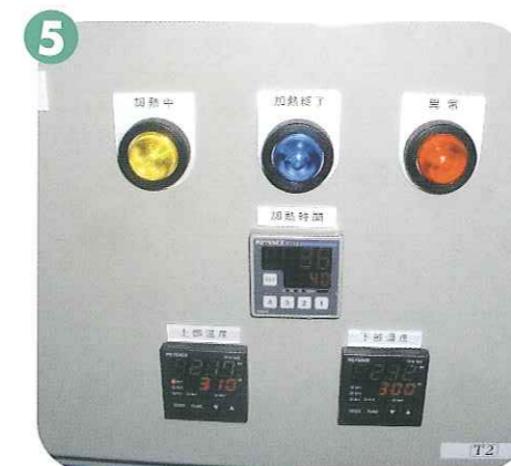
電源・真空ポンプ・ヒーター 運転表示灯
